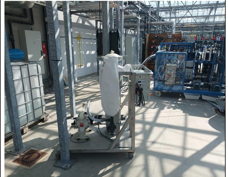
Système de filtration d'eau de mer
