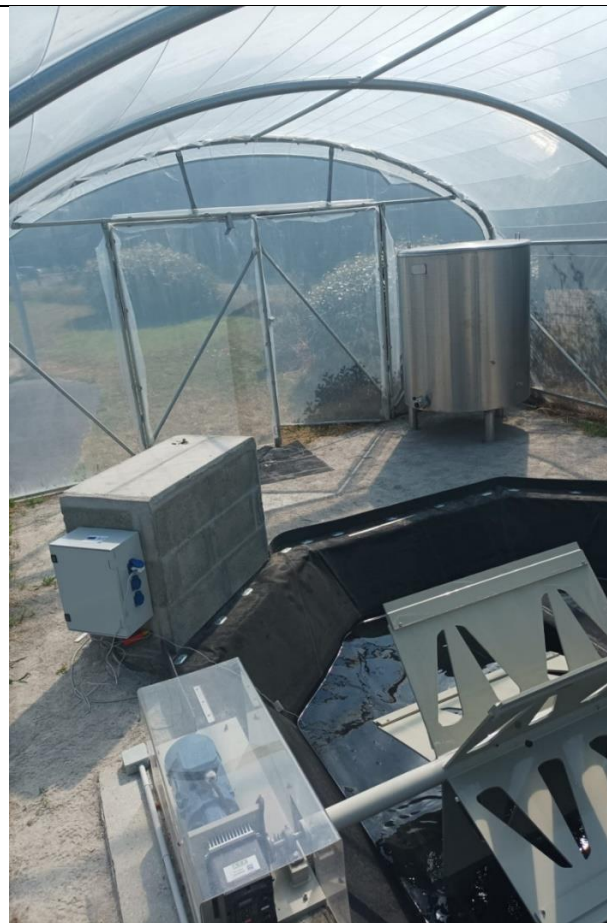
Système de production de microalgues thermo-régulé de type raceway couvert
